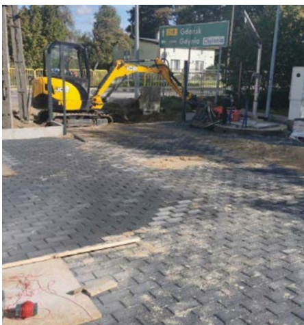
Przepompownia - Koleczkowo, ul. Wejherowska
