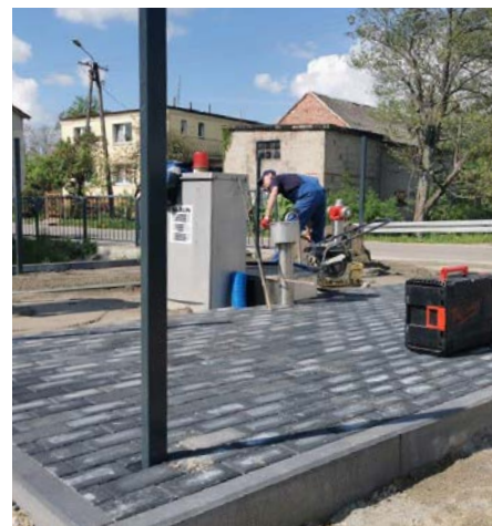
Przepompownia - Warzno, ul. Czczewska
