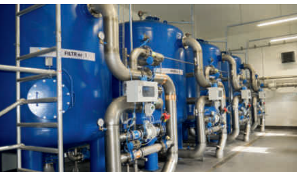
Nowoczesne wyposażenie sieci wodociągowej
