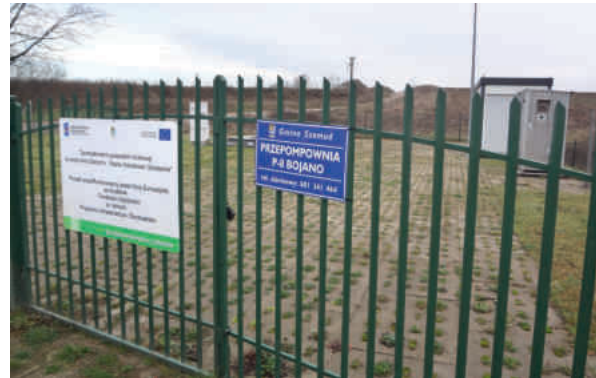
Przepompownia ścieków w Bojano
